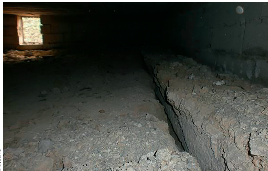
Sol décollé de la paroi d'une fondation par dessiccation - Gargas (Vaucluse).
