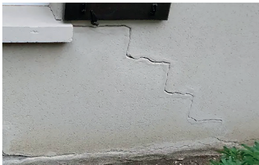
Illustration 6. Fissure en escaliers sur un mur.
