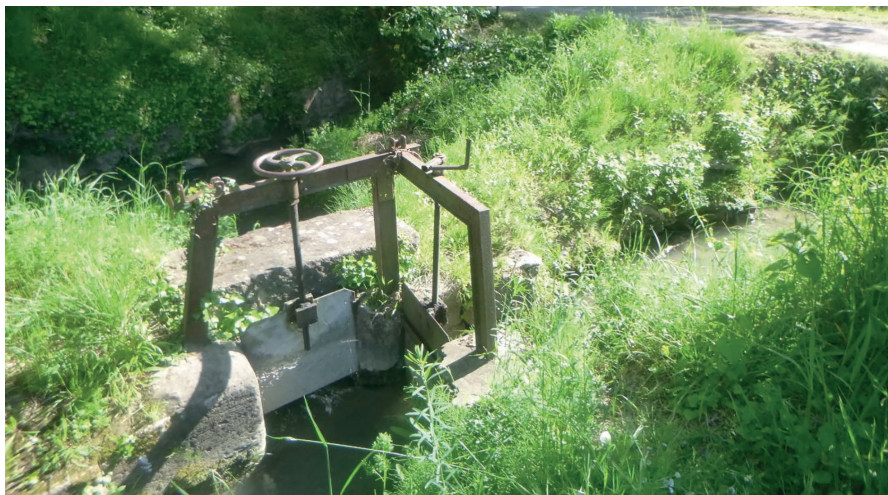
Vue de la vanne (image 9).
