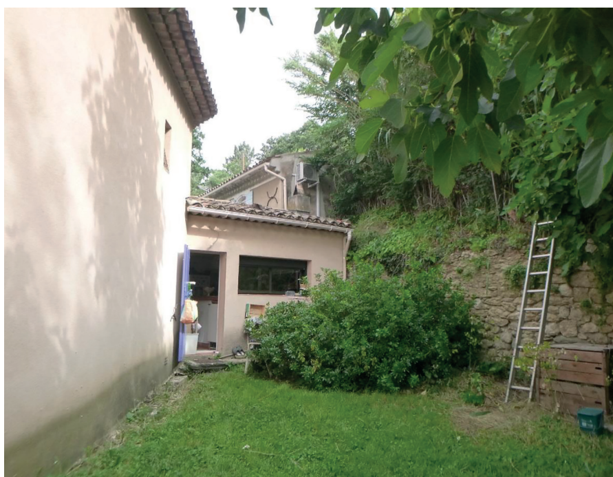
Vue de l'extension concernée par la déformation du talus et du mur (image 8).
